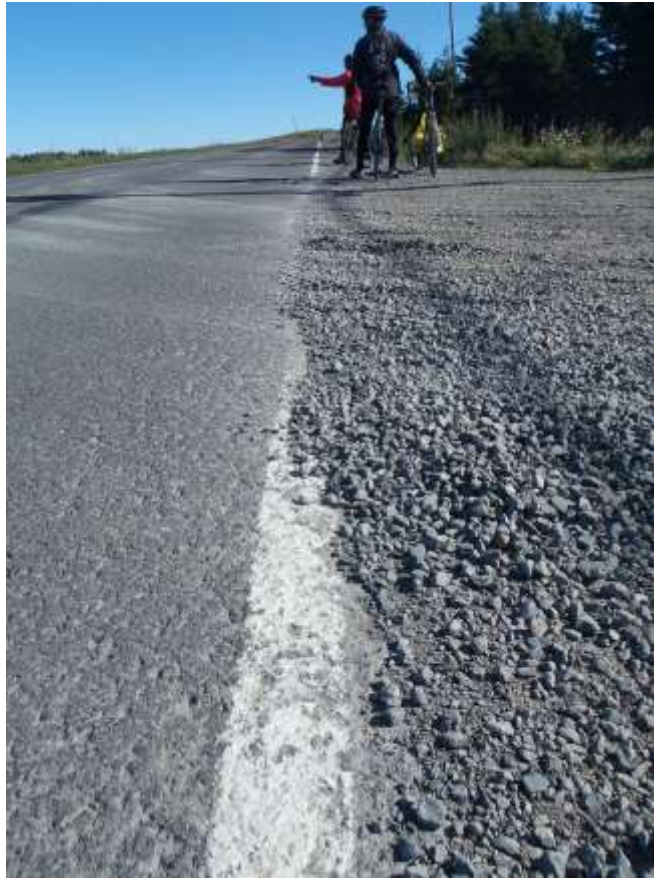
Rang 3 Ouest en direction est, la ligne blanche est parfois recouverte de gravier...
