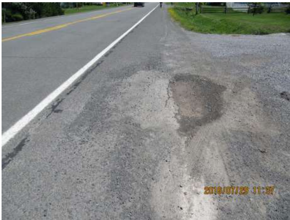
Accotement asphalté Route 132 mais en mauvais état
