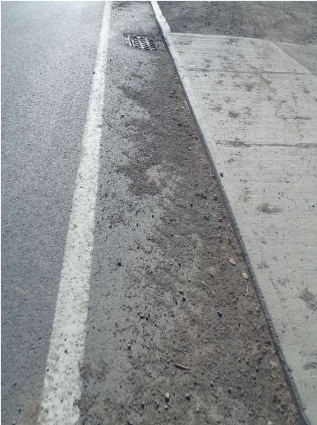
Accotement asphalté en mauvais état à plusieurs endroits sur la Route 298...
