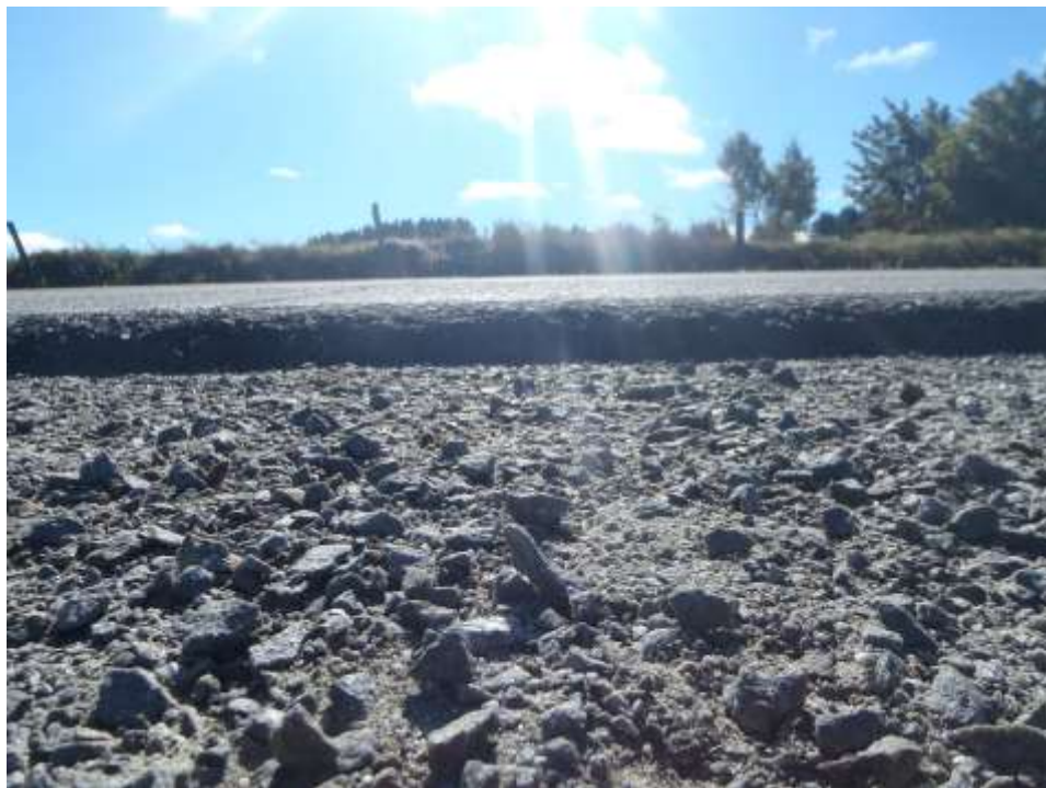
Hauteur du bitume et gravier grossier sur l'accotement non-asphalté
